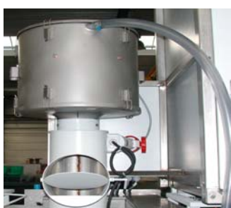
condenseur de vapeurs
